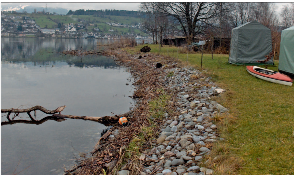
Abbildung 13: Der Erosionssaum bis zur Böschungskante wurde mit Geröll belegt. Der Übergang zur Liegewiese ist nicht mehr gefährdet (Aufnahme 22. Dezember 2008)
