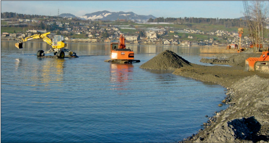
Abbildung 8: Links: Herstellung des Riffs mit Hilfe des Schrittbaggers. Rechts im Hintergrund: Einrammen der Weisstannenpfähle auf der nördlichen Schmalseite der Insel (Februar 2004)
